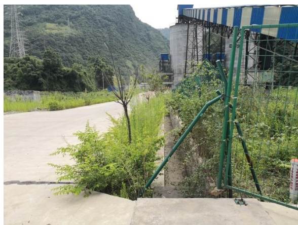
堆料场区排水沟
