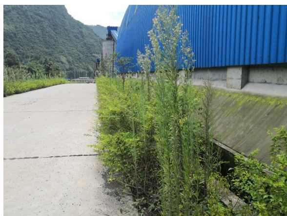
堆料场区排水沟
